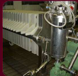
Mit Trubfiltern werden die Feststoffe abgetrennt.
